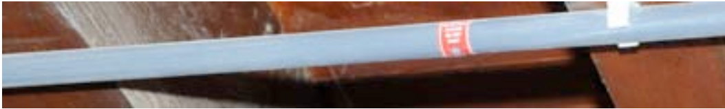
Rohrleitung unter der Decke
