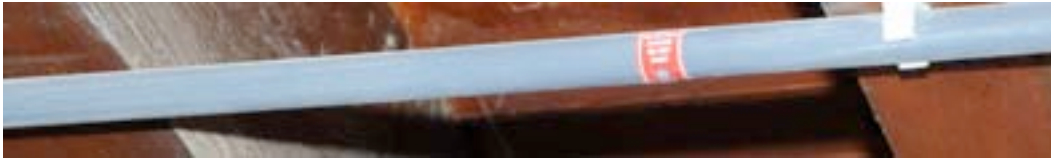
Rohrleitung unter der Decke
